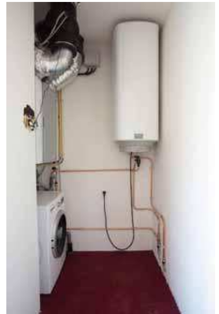
Meterkast met een techBoiler met wtw-systeem in woning met elektrische vloerverwarming en infrarood panelen.
