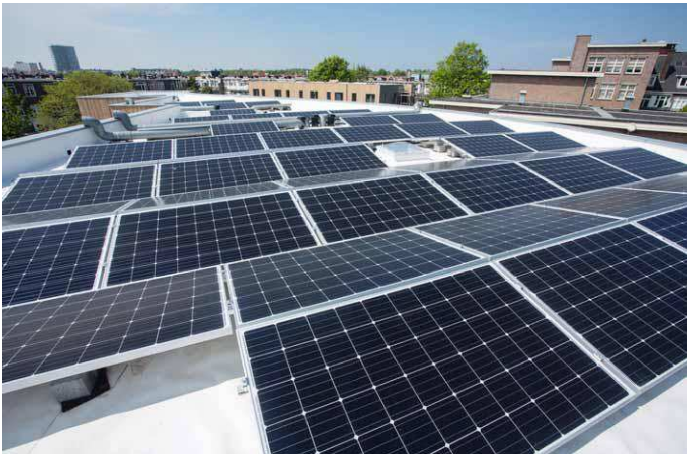
Het dak ligt vol met Pv-panelen.
