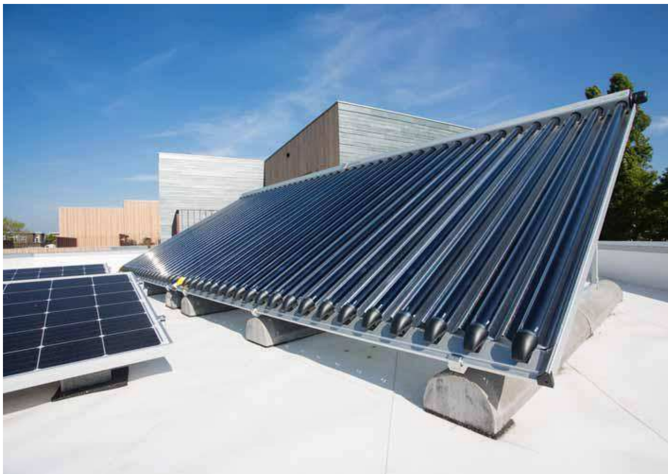
Zonnecollectoren op de daken.
