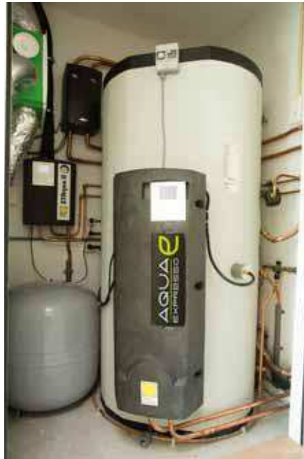
Meterkast van een 'zonthermische woning' met een megaboiler.
