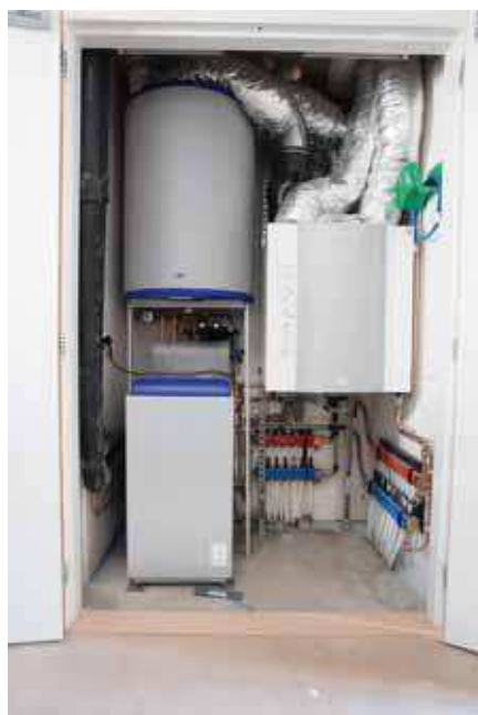
Het merendeel van de huizen in Groene Mient beschikt over een eigen warmtepomp met boiler en een WTW-systeem.
